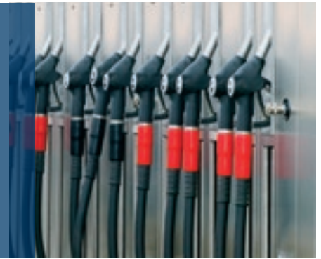
Kraftstoffversorgung im Prüffeld
